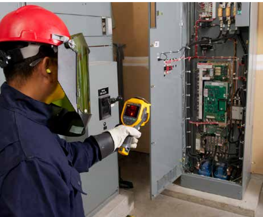
Bruk egnet 70E verneutstyr beregnet på lysbuer og stå minst 1,2 m unna når du skanner en strømførende elektrisk tavle.
