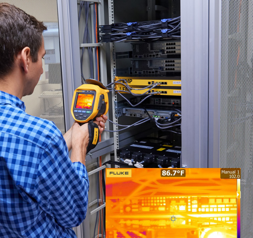
Bruk av Ti400 til å registrere varmeeffekt fra baksiden av bladservere.
