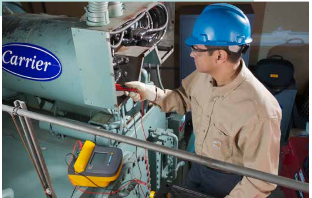
U kunt een isolatietester, zoals deze Fluke 1555, gebruiken om veel onderdelen van een boilersysteem te onderzoeken.
