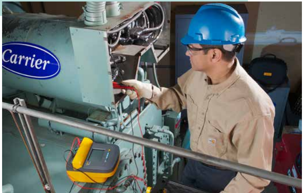
Du kan bruge en isolationstester, f.eks. denne Fluke 1555, til at checke mange dele på et kedelsystem.
