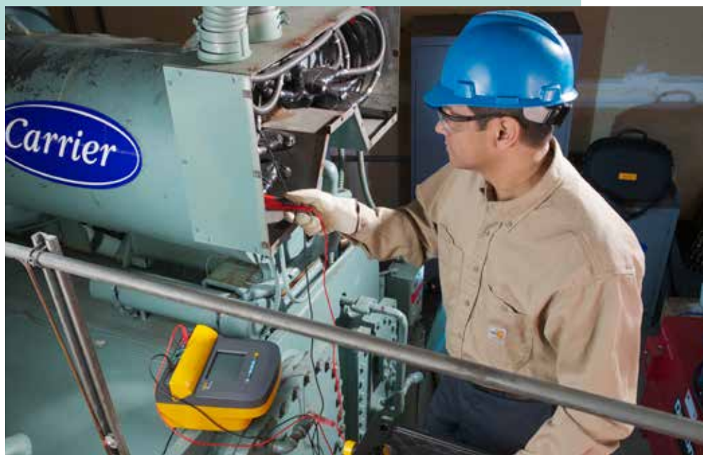
Pro kontrolu mnoha částí systému boileru můžete využít tester izolačního odporu, například tento model Fluke 1555.
